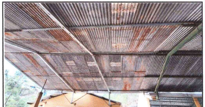
Foto 4: Laminas normales en malas condiciones
